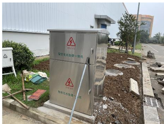
5.2-3 事故应急泵控制柜（接消防电源）
