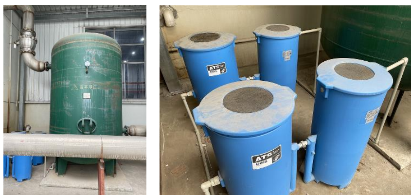
图 4.5-6 油污分离器及吸附过滤器
